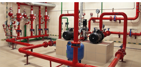
Detección y Extinción de incendios
